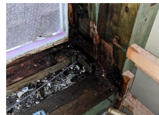
窓台の腐れ (タイルを解体すると下の木材が腐っていました)
